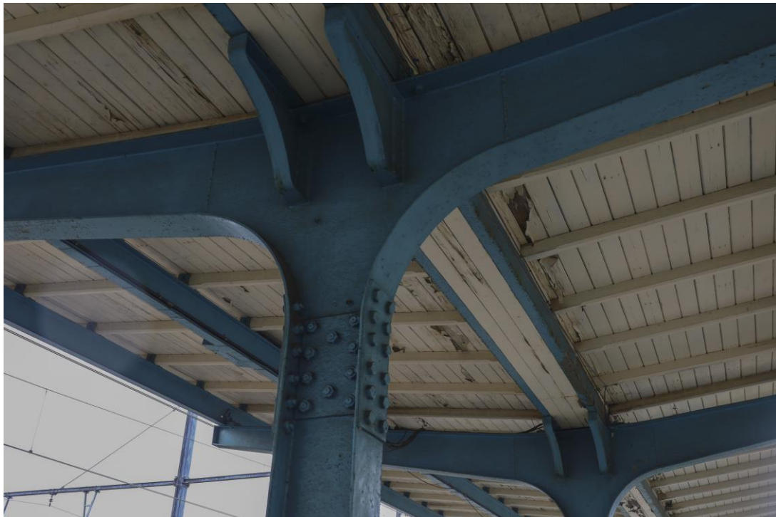
Figuur 44: detail van de perronoverkapping in typerende blauwe kleur (perron 1) 2022 – bron: fotocollectief PxL, Luc Michiels
