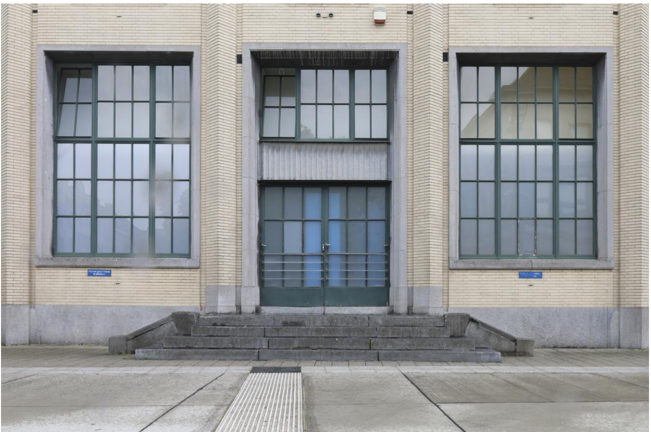
Figuur 38: detail van het stalen buitenschrijnwerk in de voorgevel 2022 – bron: fotocollectief PxL, Luc Michiels
