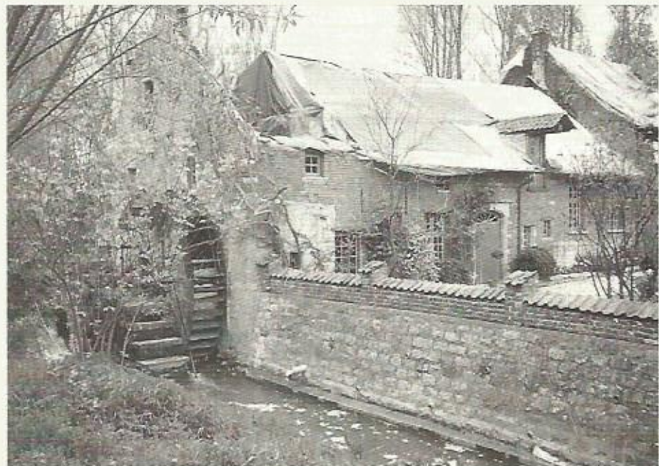
De zwaar beschadigde 's Gravenmolen na de brand in februari 1991 (foto R. Vanwetswinkel)
